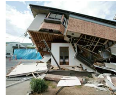
내진 셸터가 설치된 목조주택이 지진으로 붕괴된 경우
